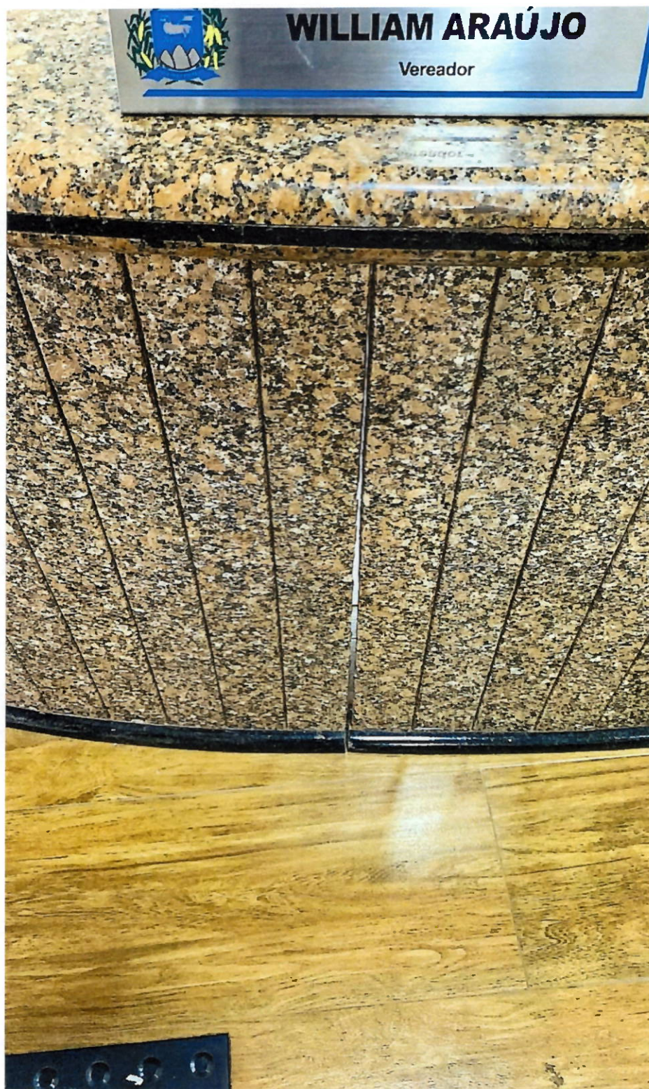
Mesa vereadores desencaixada – Risco de cair o tampão de mármore
