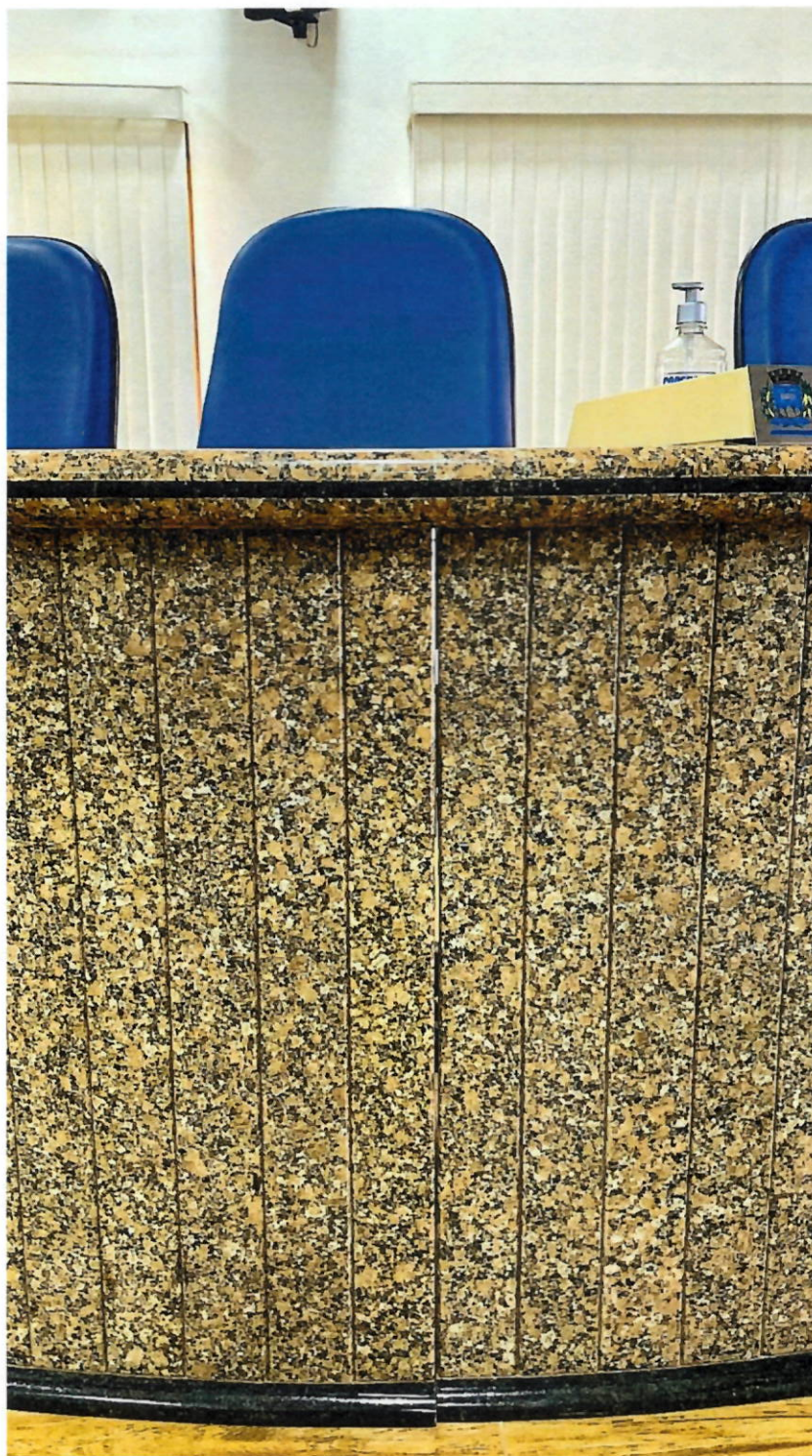
Mesa vereadores com rachadura central – Risco de cair o tampão de mármore
