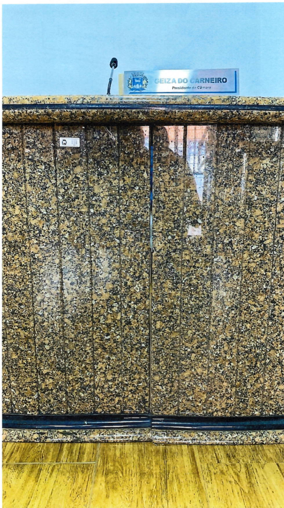
Mesa da presidência com rachadura no centro – Risco de cair o tampão de mármore
